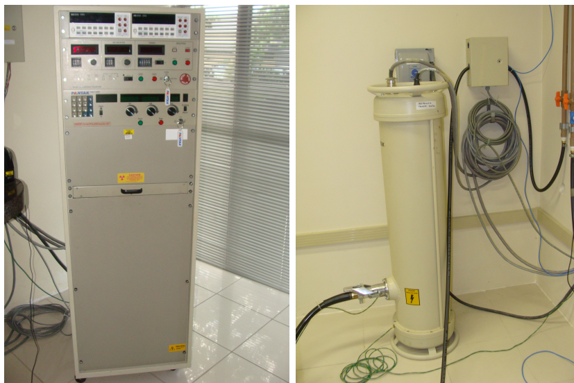
Figura 9 – Gerador PANTAK HF160 (esq.) e seu transformador (dir.).
